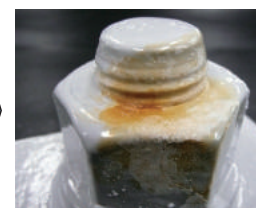
研削したピンテール破断面からは錆が発生しなかった (その他のねじ山部などから錆が発生)
