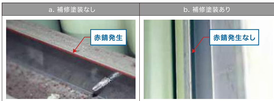
高耐食めっき鋼板製リップ溝形鋼の端面外観 (K14, 築1.5年)
