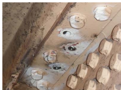
①F11T 高力ボルト破断状況
