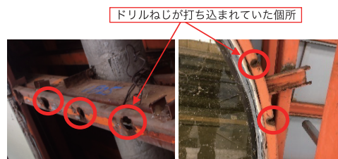
図2 ドリルねじと下地材の接触部腐食状況
